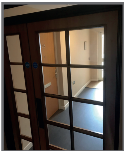
Communal Fire Door
