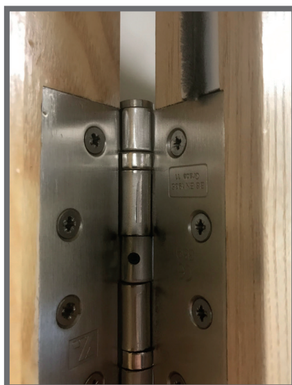
Fire Door Hinges
